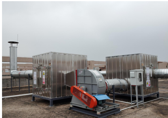
B 栋废气净化治理及排放口
