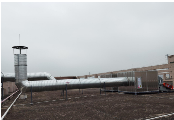
A 栋废气净化治理及排放口
